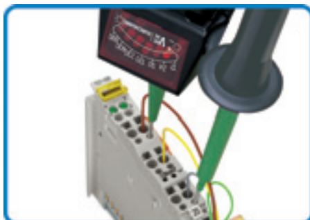
Проверка прохождения сигнала при подсоединенных проводниках
